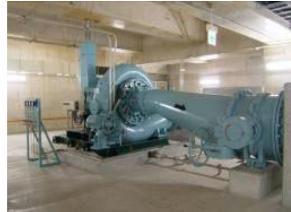
長居水力発電設備（約253kW）
