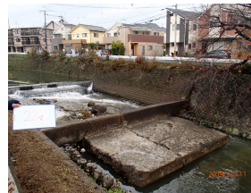
帯工・水叩工損傷
