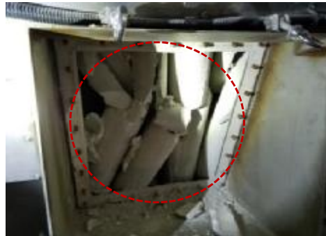
下水道焼却設備破損
