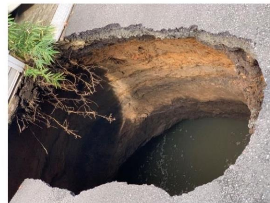
写真6 陥没箇所(2020年10月18日_13:00_西側から撮影)
