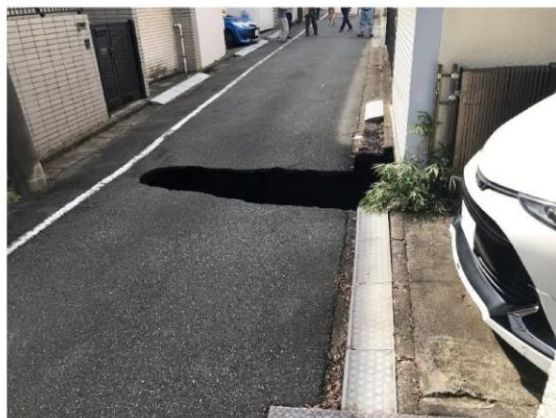
写真4 陥没箇所(2020年10月18日_12:30)
