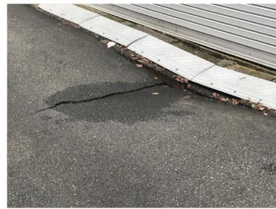
写真3 陥没箇所(2020年10月18日_11:50_舗装亀裂)
