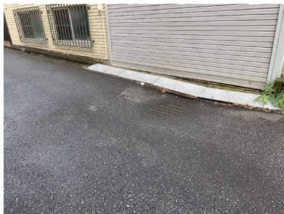
写真2 陥没箇所(2020年10月18日_9:30水たまり)
