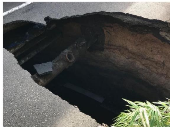
写真5 陥没箇所(2020年10月18日_13:00_東側から撮影)
