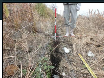
写真③ 低水護岸部の段差
