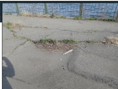
写真② 低水護岸部の舗装亀裂
