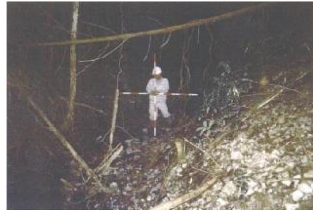
溪岸荒廃状況
