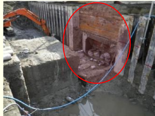
連続壁の欠損部
