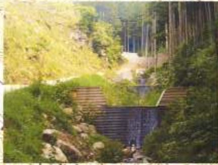
治山堰堤工施工後の状況 （下流から上流を望む） （府内産間伐材による木製残置型枠を使用）
