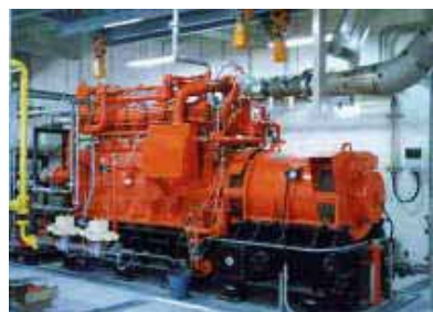
消化ガス発電機 400kW (原田水みらいセンター)
