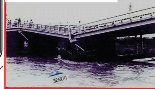
千歳橋の橋脚破損(茨木市戸伏町)
