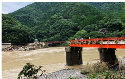
県道小鶴原女木線 深水橋 橋梁流失（熊本県八代市）
