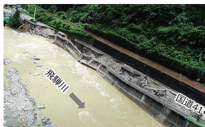
国道41号 道路崩壊 （岐阜県下呂市）
