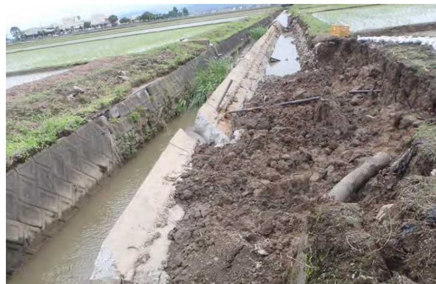
排水路の被災
