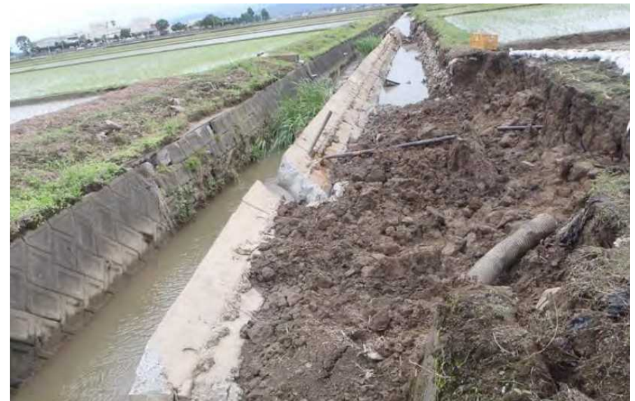
排水路の被災
