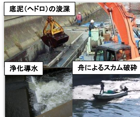
浮遊汚泥(スカム)対策の一例
