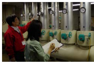
設備の運転管理状況の診断
