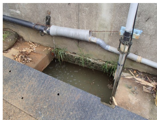
浸透水集水ピット
