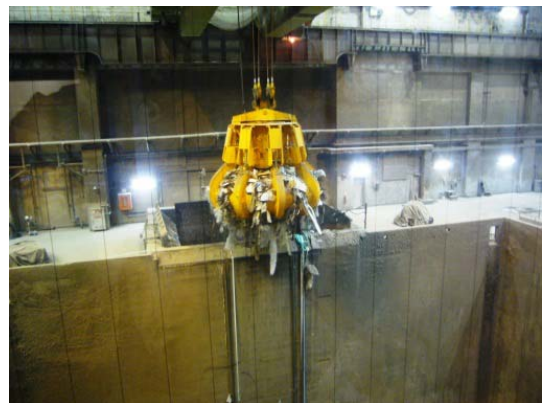
<ごみピットから焼却炉にごみを投入する様子>
