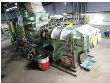
＜薬剤処理設備＞
