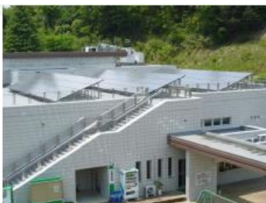
太陽光発電システム
