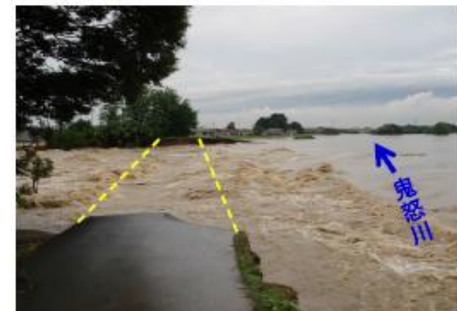
被災状況(拡大写真)
