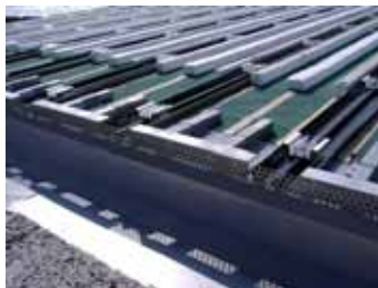
実習棟屋根を利用した集熱システム
