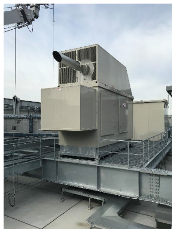
<非常用発電機>
