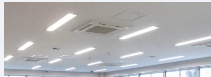
ベース照明・パッケージエアコン
