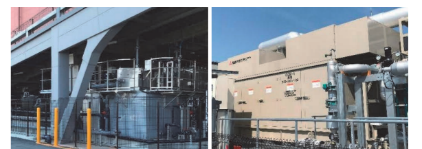
バイオガスシステム
