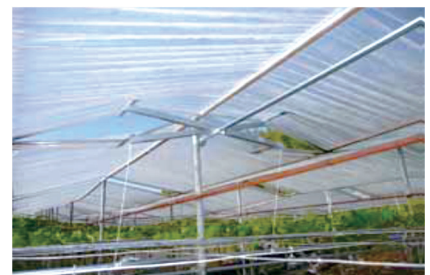
▲天井ビニール開閉装置
