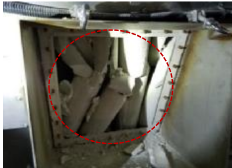
下水道焼却設備破損
