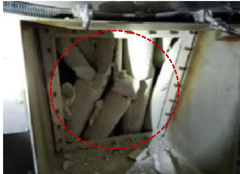
下水道焼却設備破損
