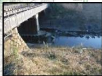
船橋川H30-1 河床の洗掘
