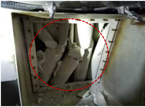
下水道焼却設備破損
