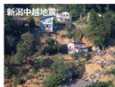
国土交通省北陸地方整備局 「平成16年新潟県中越地震による被害と復旧状況～復旧から復興へ～」より
