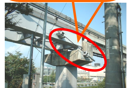
耐震対策(大阪モノレール)
