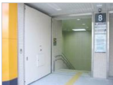
▲ 止水扉の設置事例
