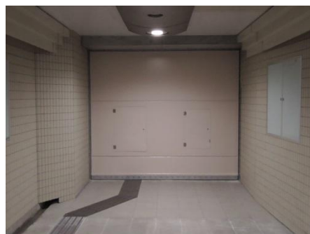
止水扉の設置状況（浸水時） （阪神本線 福島駅）
