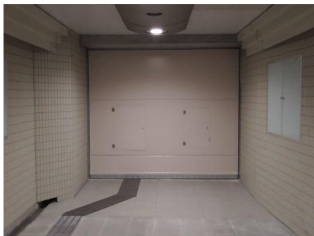
止水扉の設置状況 阪神本線 福島駅（南出入口）
