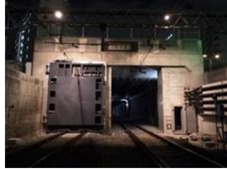
止水扉の設置状況 阪神本線 福島駅（トンネル坑口）
