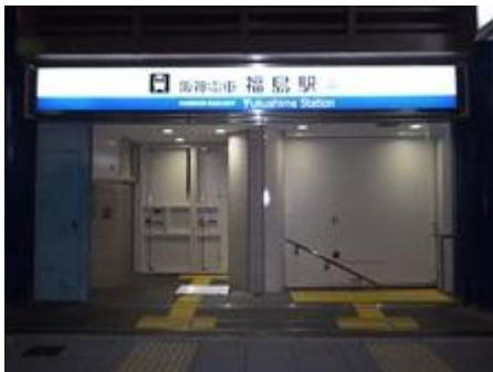
止水扉の設置状況 阪神本線 福島駅（東出入口）
