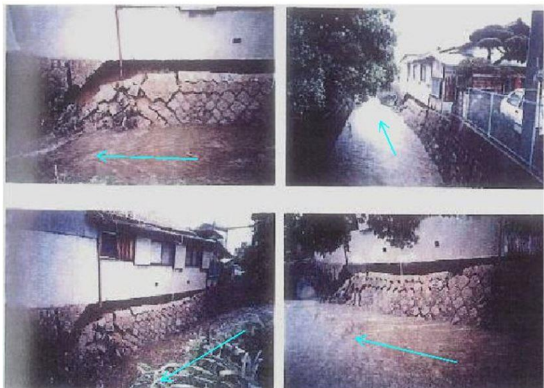
平成7年5月豪雨被害：前川(砂子橋上流)
