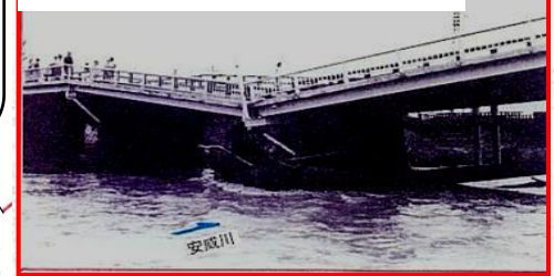
千歳橋の橋脚破損(茨木市戸伏町)
