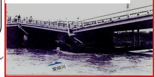
千歳橋の橋脚破損(茨木市戸伏町)
