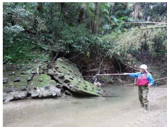
老朽化護岸(破損)
