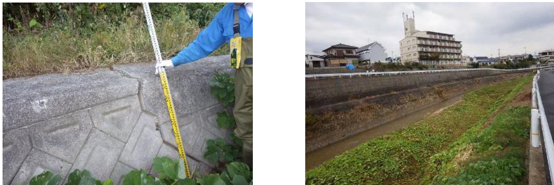
図-2.7 平成26年度末時点で津田川水系で確認される損傷・土砂堆積例
