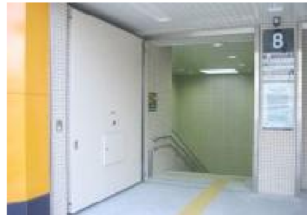
止水扉の設置事例
