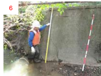
6 護岸クラック
