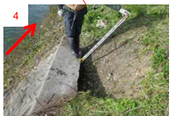
4 護岸背面土砂流出
