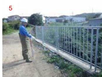
5 護岸背面土砂流失
