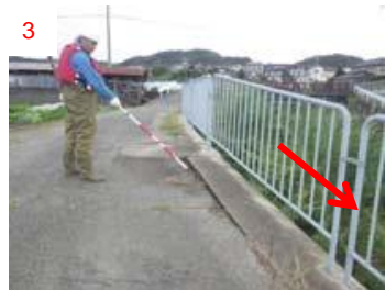
3 管理用通路沈下
