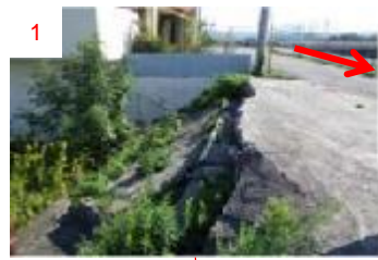
1 堤防裏法陥没
