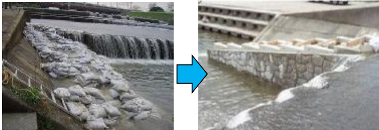
H18.3土のうによる簡易魚道
