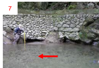
7 河床局所洗掘
