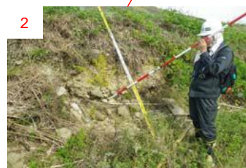
2 堤防表法表土流出
