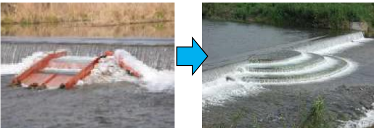
H25.3 鋼製簡易魚道
