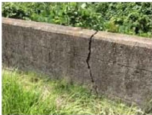
パラペットのクラック
