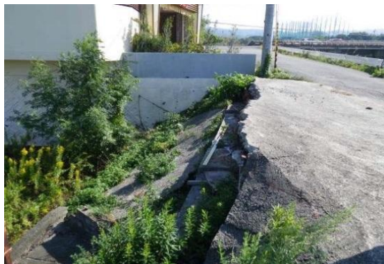
堤防裏法面の陥没
