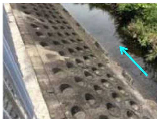
護岸基礎部の洗掘による 背面土砂の流出に伴う護岸の沈下
