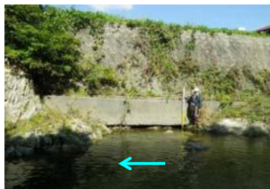
局所洗掘による護岸基礎部の露出
