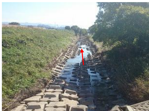
檜尾川 淀川合流点付近 (約500mにわたり、護床ブロックが設置されている)
