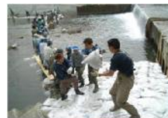
土のうによる護岸崩壊の危険
