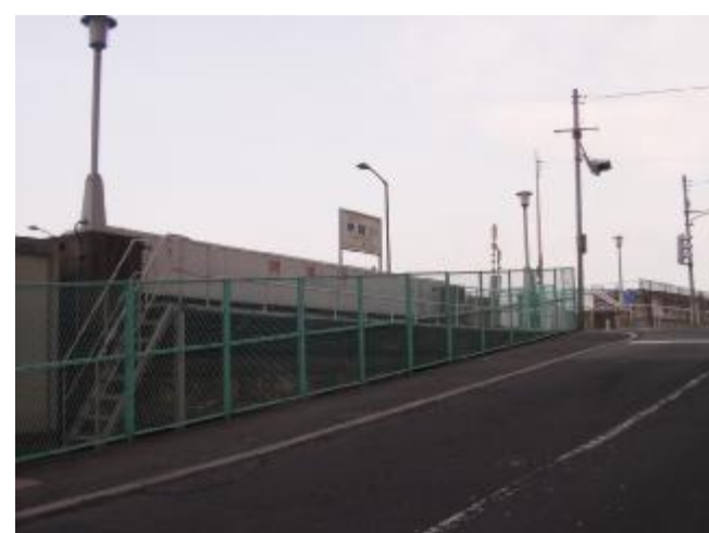
千北橋左岸防潮扉(アルミ防潮扉)
