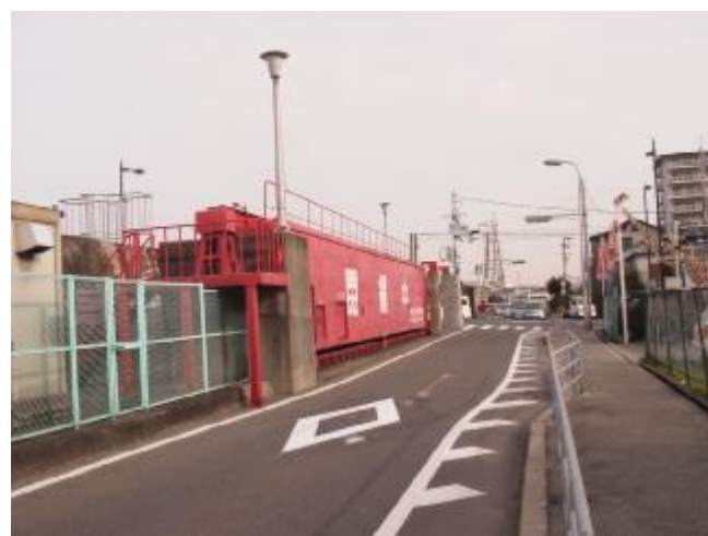
神崎大橋左岸防潮扉(油圧走行引戸式鉄扉)
