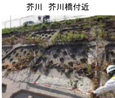
護岸ブロックの損傷、開き
