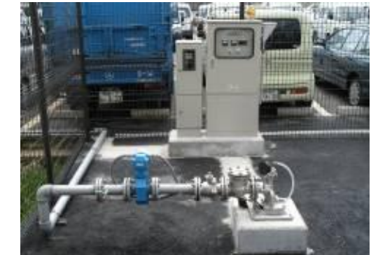
写真 1.7 地下水の導水(恩智川)
