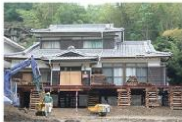
宅地嵩上げ・ピロティ
