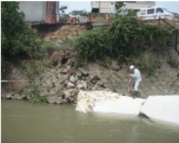
河川管理施設（構造物の損傷）
