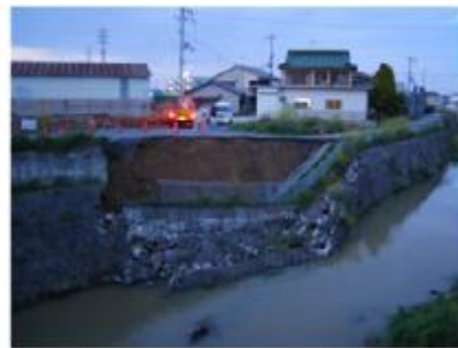
②平成16年5月降雨による百舌鳥川の被災状況(尾羽根橋上流)
