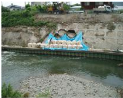
①平成19年8月降雨による石津川の被災状況(宮本橋上流)
