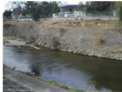
④平成23年1月降雨による石津川の被災状況(万崎橋下流)
