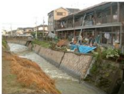
③平成18年6月降雨による和田川の被災状況(草部橋下流)
