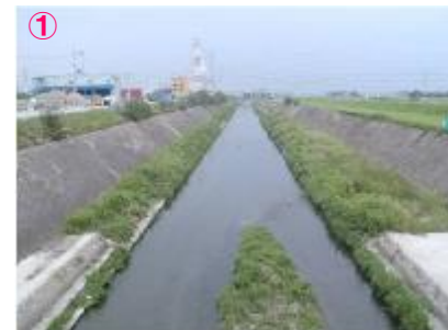
① 東除川（明治小橋より下流） 両岸コンクリートブロック護岸の人工的な様相ですが、右岸側は並流する大和川により緑と水面の広がりを見せています。
