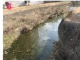
③ (宇橋より上流) 未改修区間の両岸コンクリートブロック護岸で河道幅は下流に比べ狭く、土砂が右岸側を中心に堆積が多くなっています。
