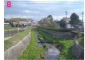
⑧ 三津慶川(地藏橋より上流) 両岸コンクリート護岸で河道幅は極端に狭く、河床に形成された砂州には雑草が繁殖しています。
