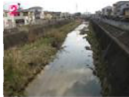
② (狭間小橋より上流) 両岸コンクリートブロック護岸の単断面型河道です。
