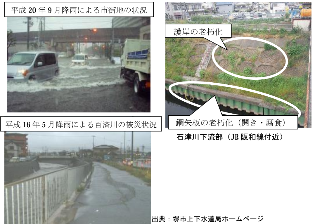
図 1.2.2 過去の被災状況および護岸の老朽化
