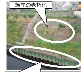
鋼矢板の老朽化（開き・腐食）
