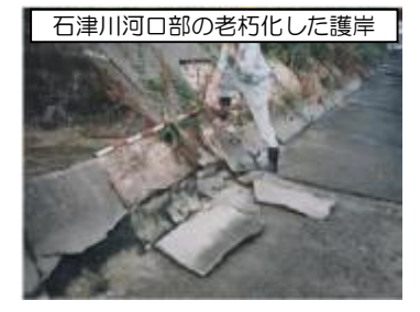
石津川河口部の老朽化した護岸
